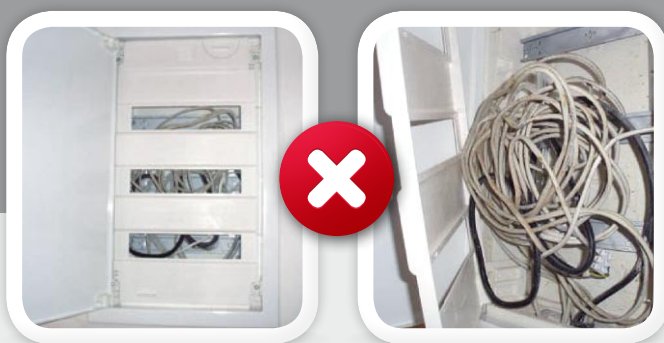
„KONKURENČNÍ ŘEŠENÍ“ – Instalace datových rozvodů bez řešení STAKOHOME
